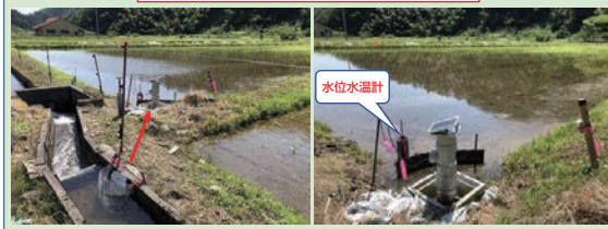
WATARAS開水路ゲート式(R3~継続設置)
