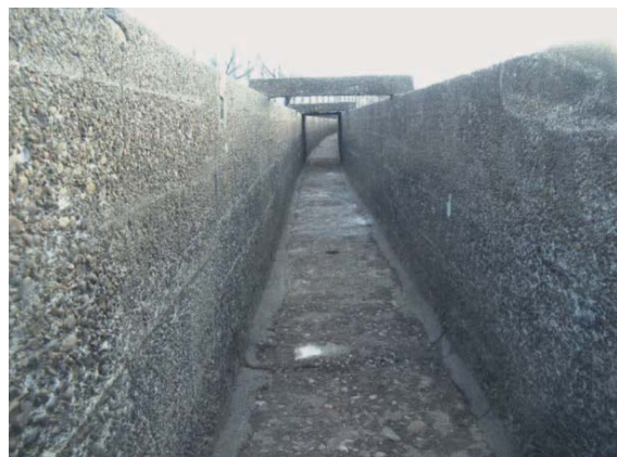
摩耗が著しく、目地や亀裂からの漏水が見られ通水に支障がでている水路
