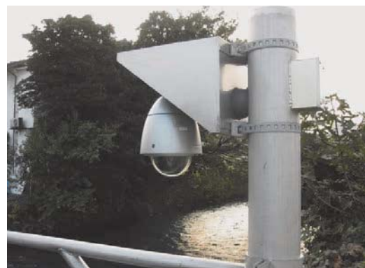
監視カメラの設置
