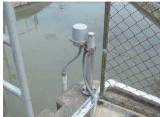
水位計測器の更新
