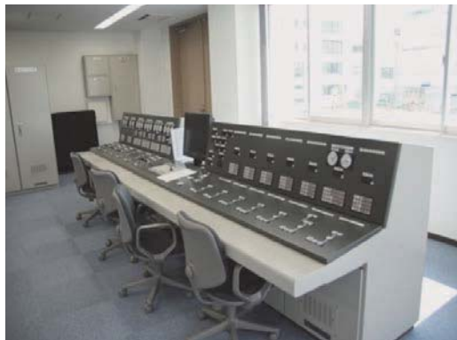
監視制御機器の更新
