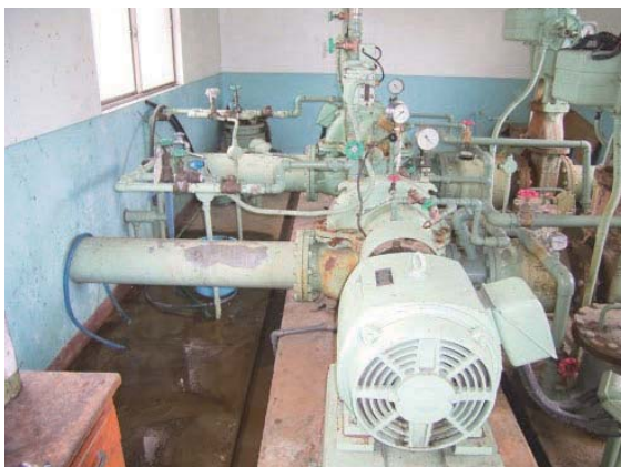
造成から10年以上経過し、運転に支障が出ており、分解補修が必要な揚水ポンプ
