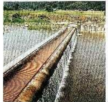
① 矢下頭首工
