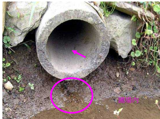
取水管からの漏水事例
