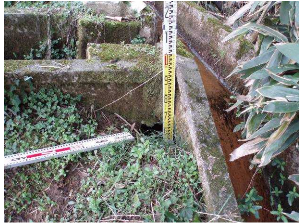
底部分の陥没事例
