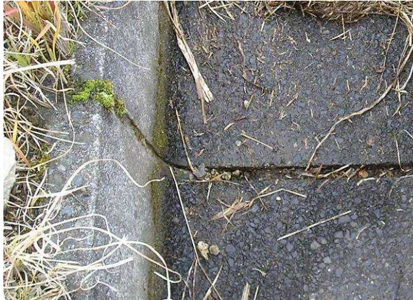
目地剥落事例 (目地材が抜けた状態)
