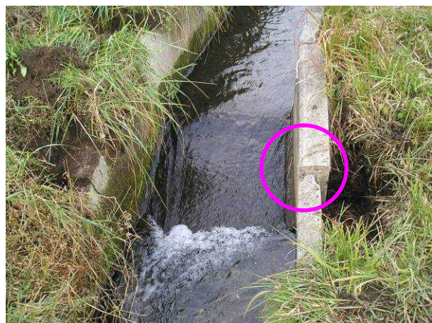
落差工の沈下事例
