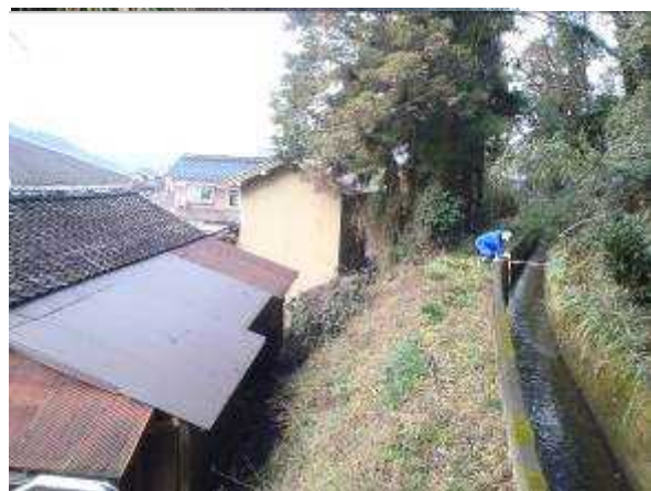
山中や斜面にある水路の適正管理 (泥上げや草刈りが行われることで、溢水による法面崩壊等の危険性は少なくなる。)
