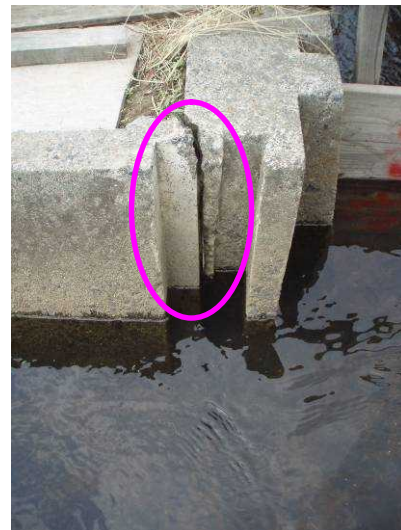
分土工接合部 (接合部に亀裂が発生している)
