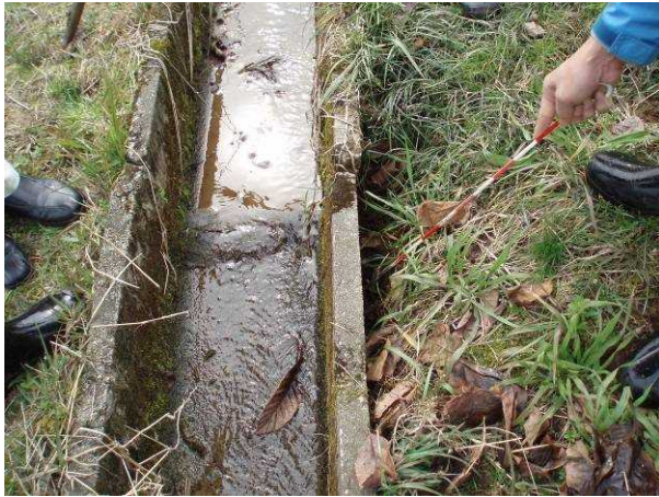
水路肩の陥没事例
