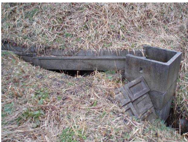
落差工の沈下事例
