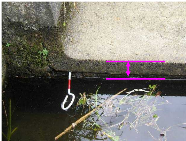
柵接合部 (接合部に隙間があるため、漏水により水路の高さまで水が溜まっていない)
