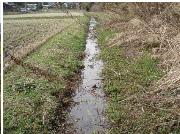
排水路の通水阻害例
