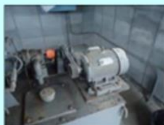
老朽化したポンプ
